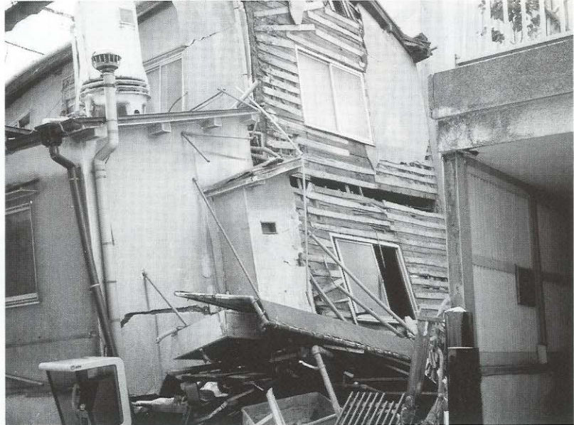
阪神・淡路大震災く住吉中心市街地住宅破損状況 (H7・3・11調査)
